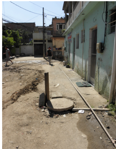
Figura 11 – Precariedade do sistema de abastecimento e esgotamento em Caminho da Creche.
