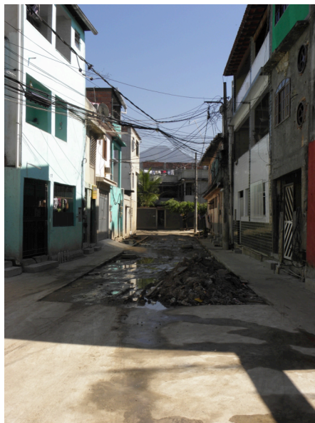
Figura 29 – Parte da via pavimentada e problemas com a continuidade da obra.
