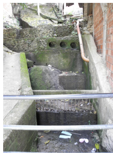
Figura 34 – Saída de águas servidas – Chapéu Mangueira.
