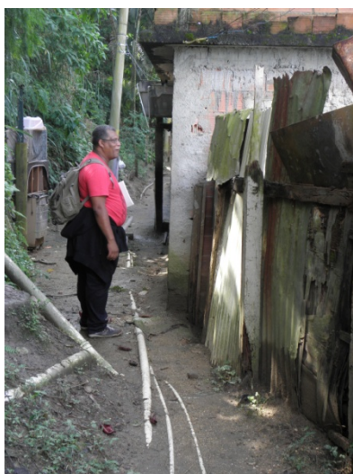
Figura 32 – Tubulações de água em caminho na área limite da APA – Babilônia.
